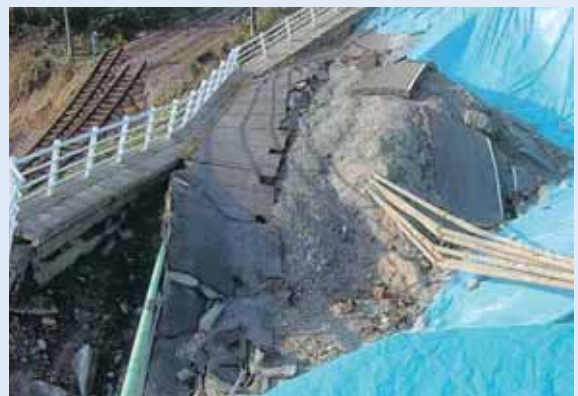
2004年 新潟県中越地震における国道17号線崩壊箇所で見られたライフライン各種埋設管の被害 (写真は基礎地盤コンサルタンツ(株)森本氏による)
